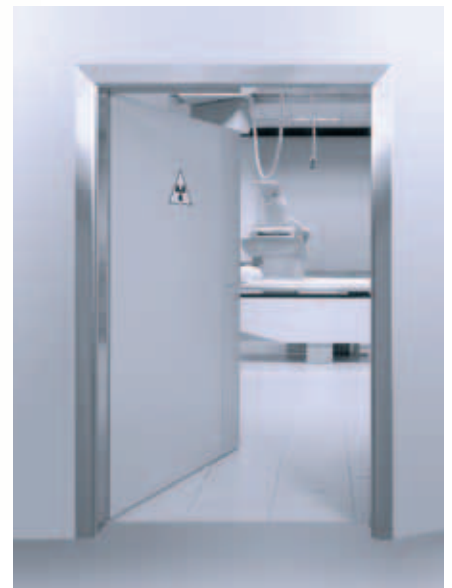
Auskleidung mit Blei für Strahlenschutz, Röntgenräume
